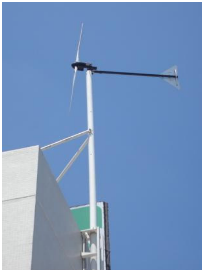
Figura 9 - Aerogerador que se encontra instalado no topo do Centro Empresarial Eolis
