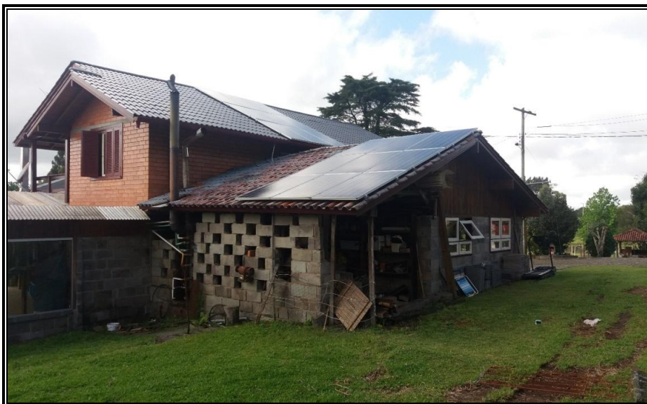
Figura 8 – UFV Instalada em Propriedade Rural no Município de Gramado/RS
