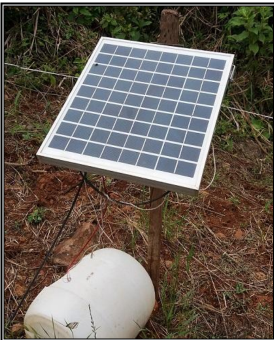
Figura 6 - Eletrificador Solar de Cerca em Operação
