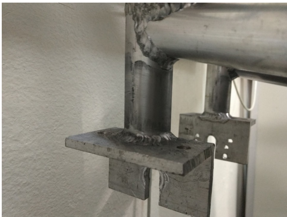
Figura 28: Detalhe da suspensão traseira após lixamento.
