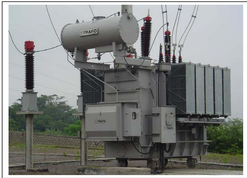
Figura 4.2 – Imagem do transformador de potência da Subestação São Leopoldo (TRAFO, 36/48/60 MVA, 138/26 kV)
