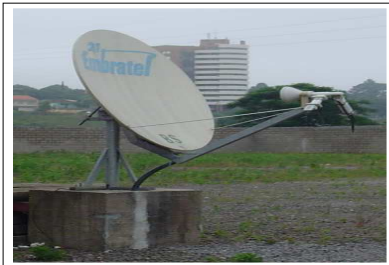
Figura 4.4 – Unidade transmissora de dados usada na SE São Leopoldo
