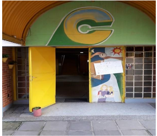
Figura 6: Porta de acesso ao bloco A, primeiro piso, onde fica localizada a biblioteca
