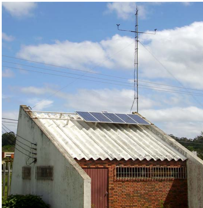
Figura 4.1. Sistema fotovoltaico autônomo com uma potência de 500Wp, instalado no prédio anexo ao Laboratório de Energia Solar da UFRGS.
