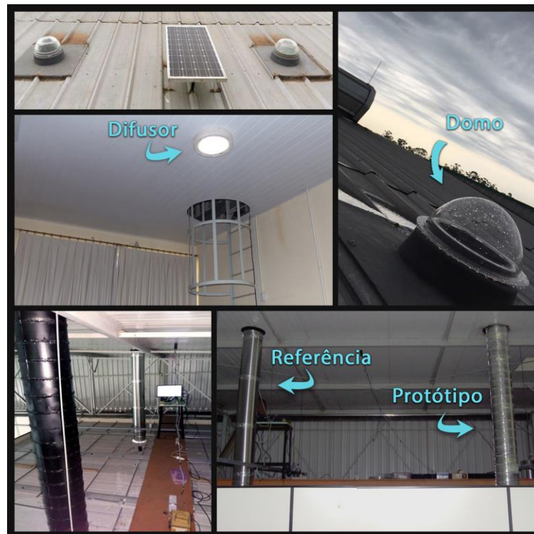
Figura 54 – Ambiente de validação com os protótipos instalados
