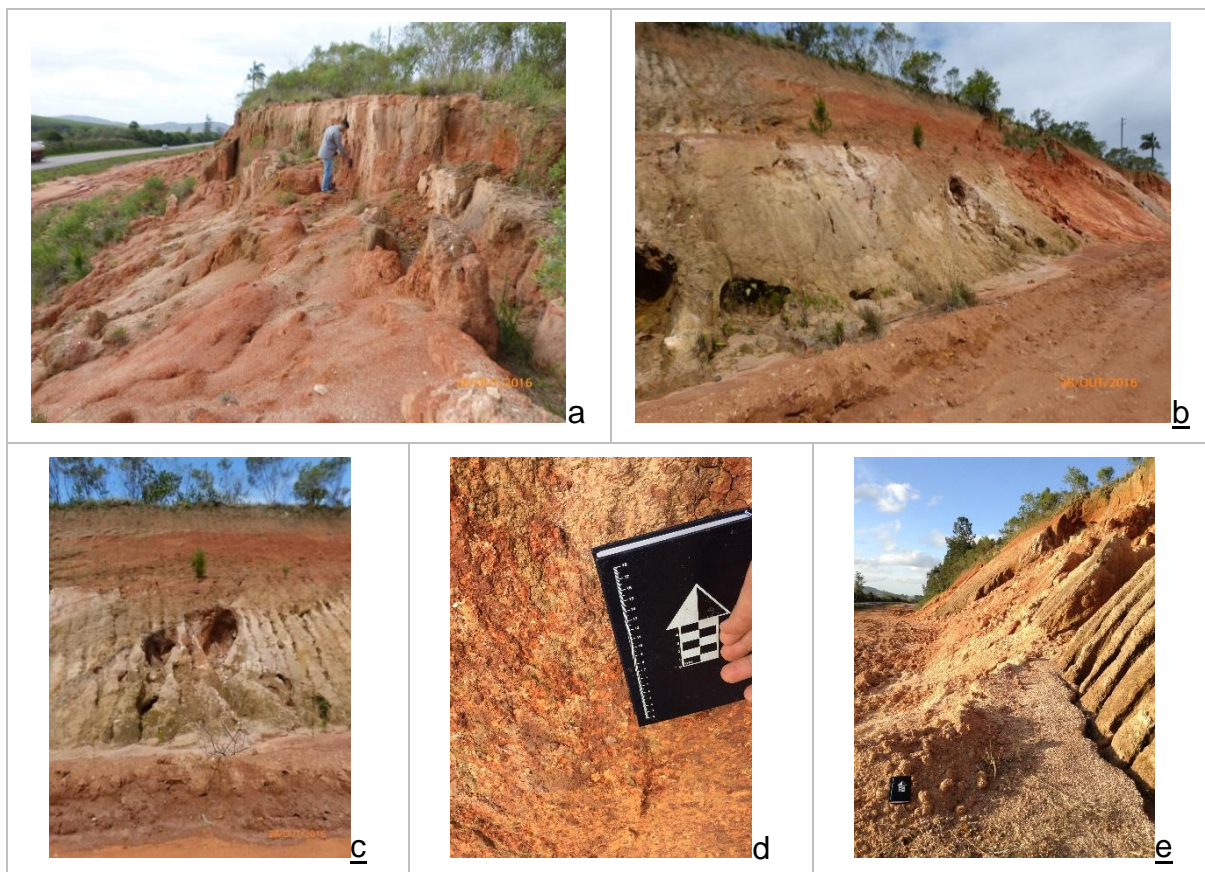
Figura 56: a) detalhe da ruptura. b) e c) horizonte C e R com cavernas formadas pelo processo de piping. d) Monzogranito grosseiro alterado. e) material carregado dos horizontes superiores.
