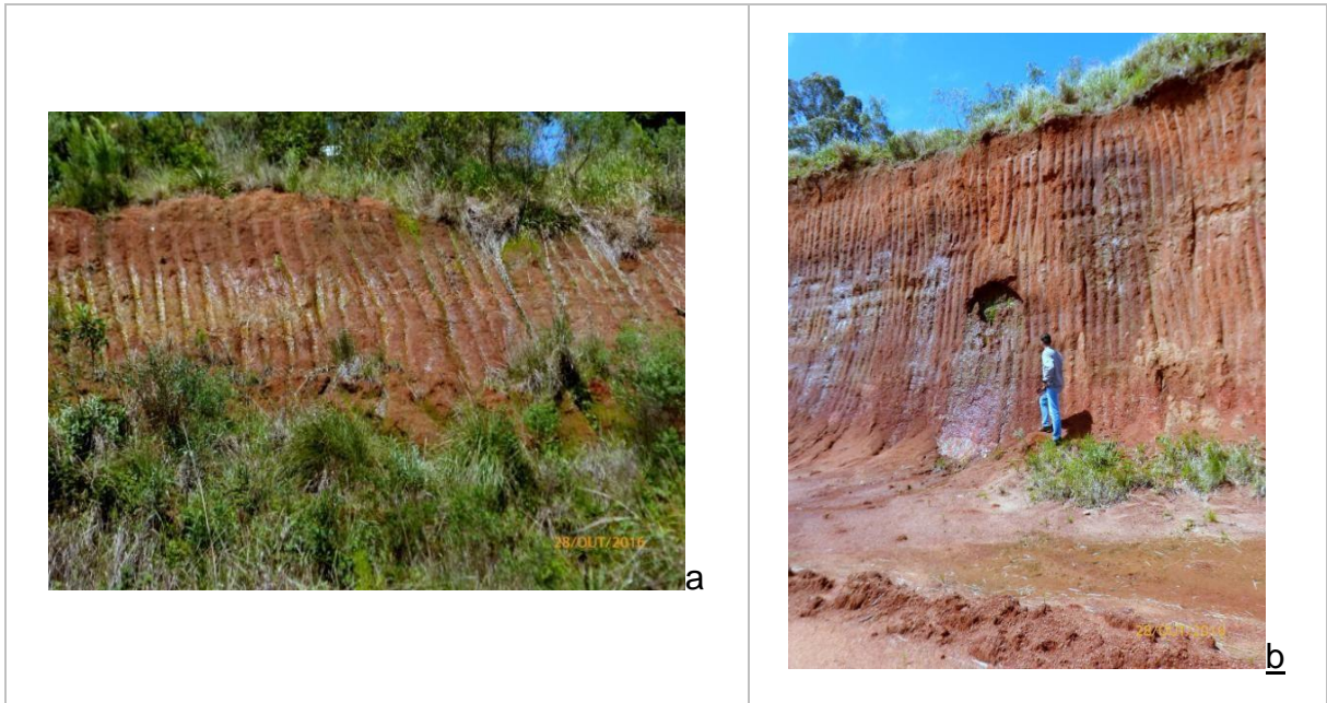
Figura 54: a) presença de limo, vegetação rasteira e água na face do talude. b) horizonte B espesso e coeso;
