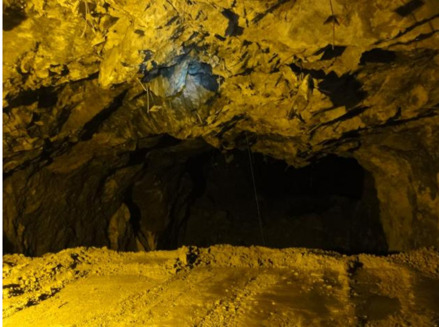
Figura 66 - Foto da operação de preenchimento da câmara TS_N195_E1, mostrando a grande extensão de teto não fortificado, e a irregularidade do mesmo devido à caída de blocos.
