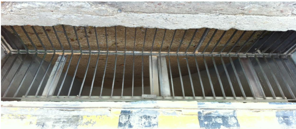
Figura 3 – Moegas primárias desprovidas de abrigo contra intempéries e pragas na Companhia Estadual de Silos e Armazéns/Porto Alegre (2017).
