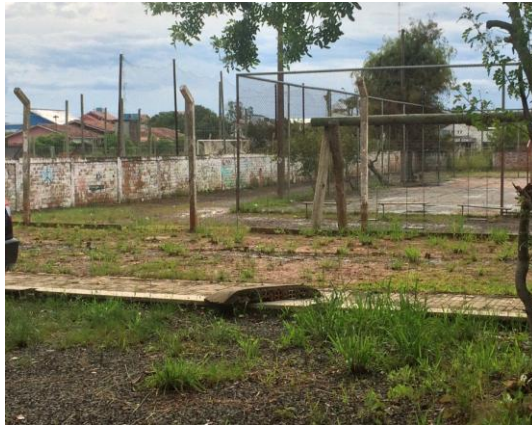
Figura 36 - Rampas que se soltaram
