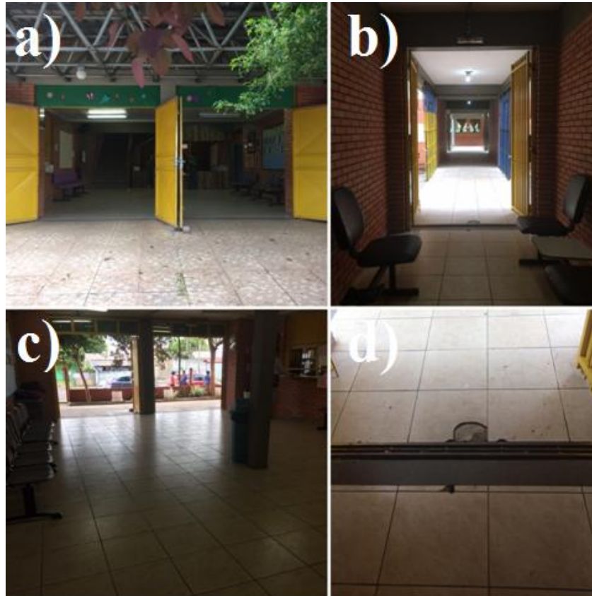
Figura 32 - a) Portas de entrada do prédio; b) Corredor principal; c) Vista do saguão de entrada; d) Trilho da porta do corredor.
