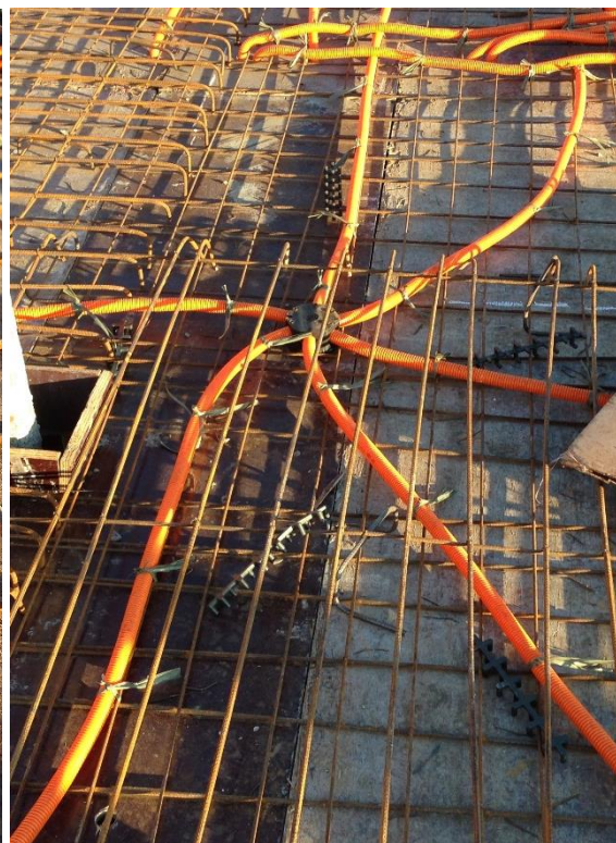
Figura 13 – Espaçadores tombados ou mal colocados
