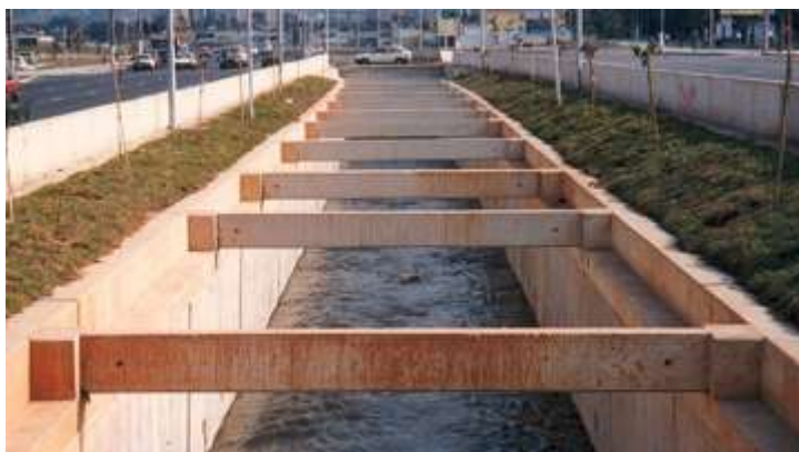
Figura 28 – Parede de Diafragma Estorcida
