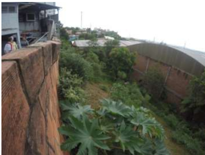
Figura 3 – Talude de 7 metros de altura e aproximadamente 35° de inclinação, ao lado da estrutura de contenção que rompeu. No local da estrutura havia um talude semelhante porém de menor inclinação
