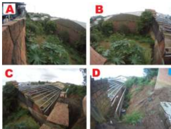
Figura 2 – Sequência de fotos de A a D, demonstra o local do talude existente ao lado da queda de muro
