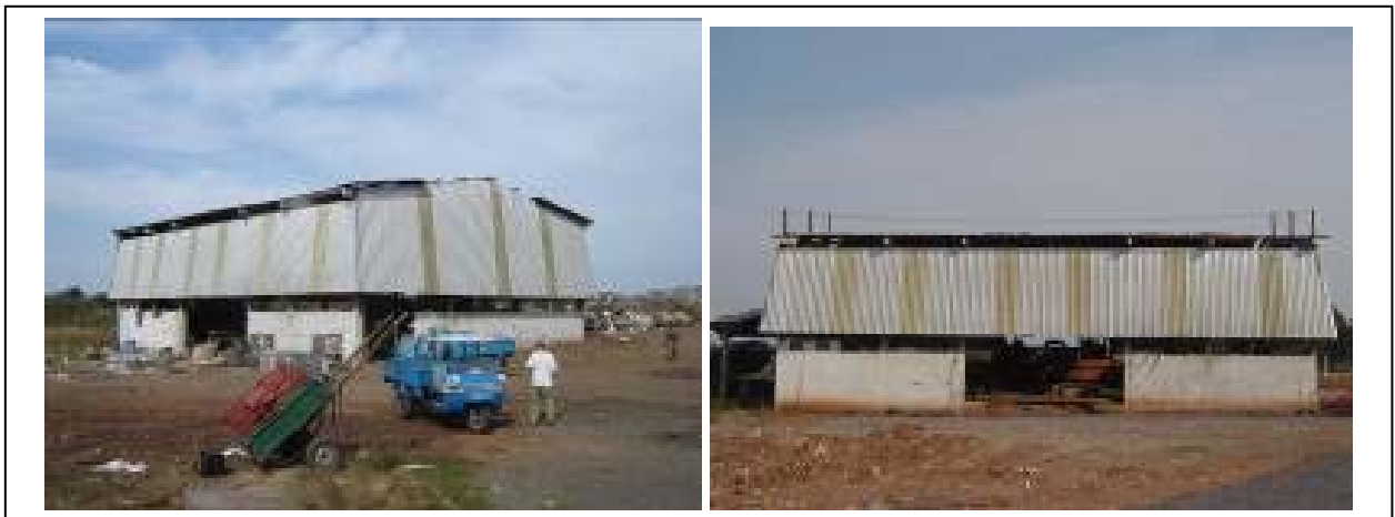
Figura 5 – Antes e depois da colocação da linha de vida para trabalhos em altura
