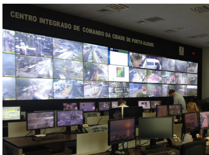
Figura 6 - Sala de operações do CEIC
