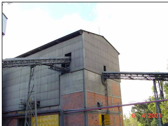
Figura C.9 – Galpão que abriga o circuito de moagem: detalhe das correias transportadoras de alimentação do moinho.
