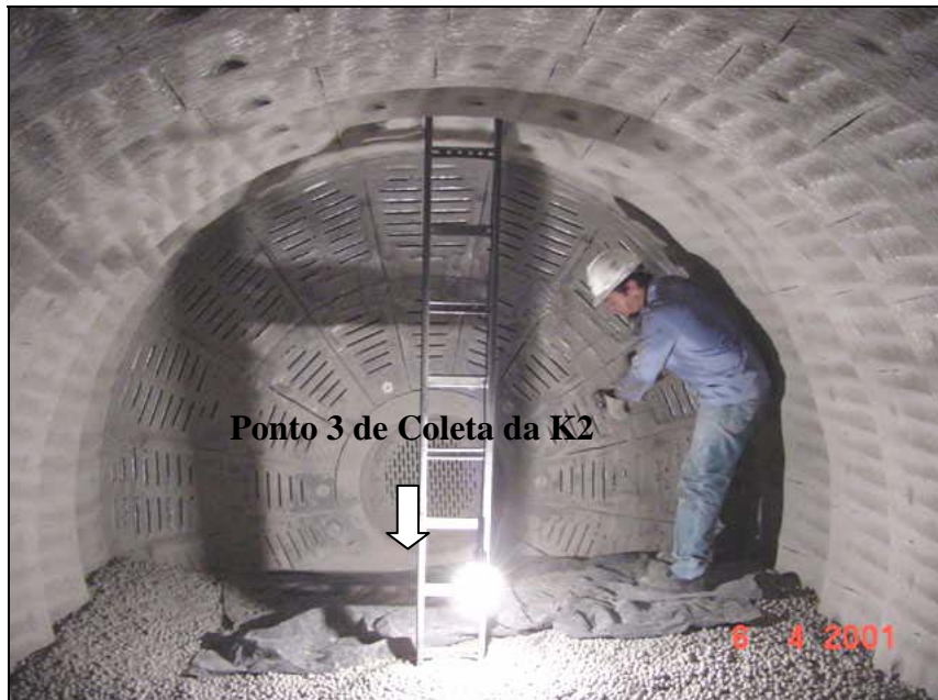
Figura 18 – Grelhas de saída da câmara 2.
