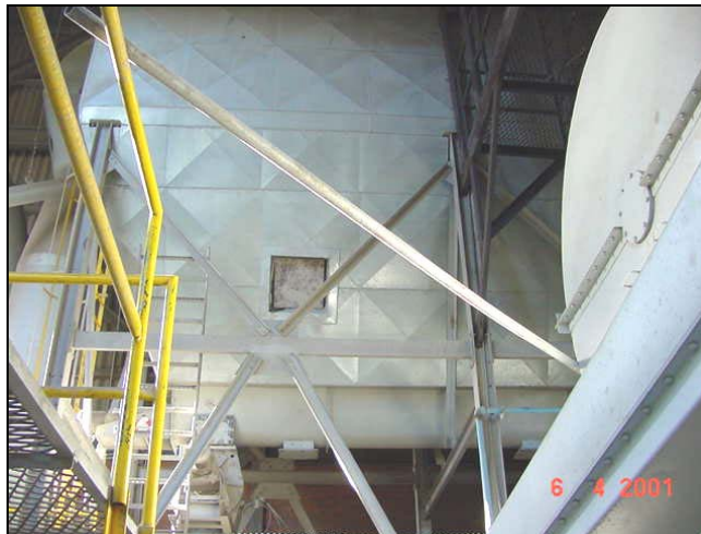
Figura C.8 – Filtro de magas do circuito de moagem de cimento.
