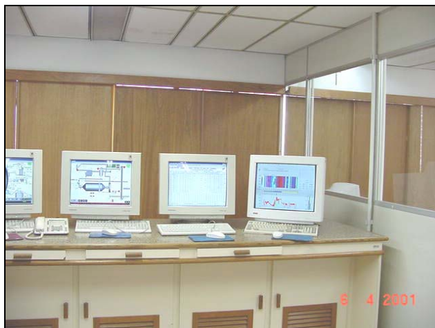
Figura C.13 – Telas dos monitores da sala de controle do circuito de moagem.
