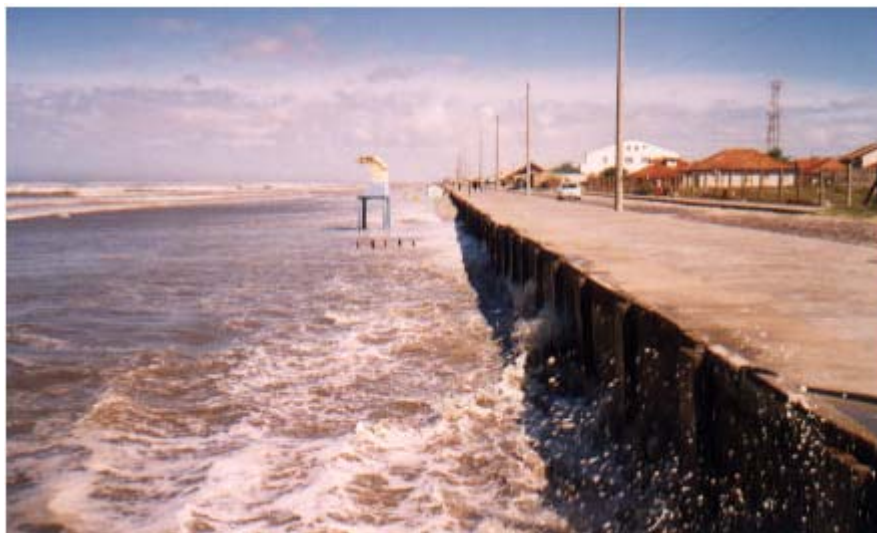
Foto 1: Impacto Frontal de uma maré meteorológica em construção junto à orla marítima na praia de Cidreira. NICOLODI, 1999.
