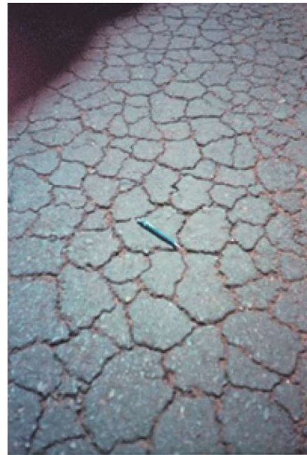
Figura 5 – Trincas interligadas sem direção preferencial
