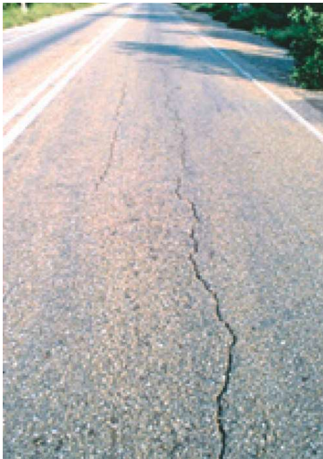
Figura 4 – Trincas isoladas longitudinais
