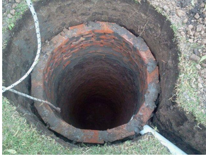
Figura 11 – Fossa negra de alvenaria
