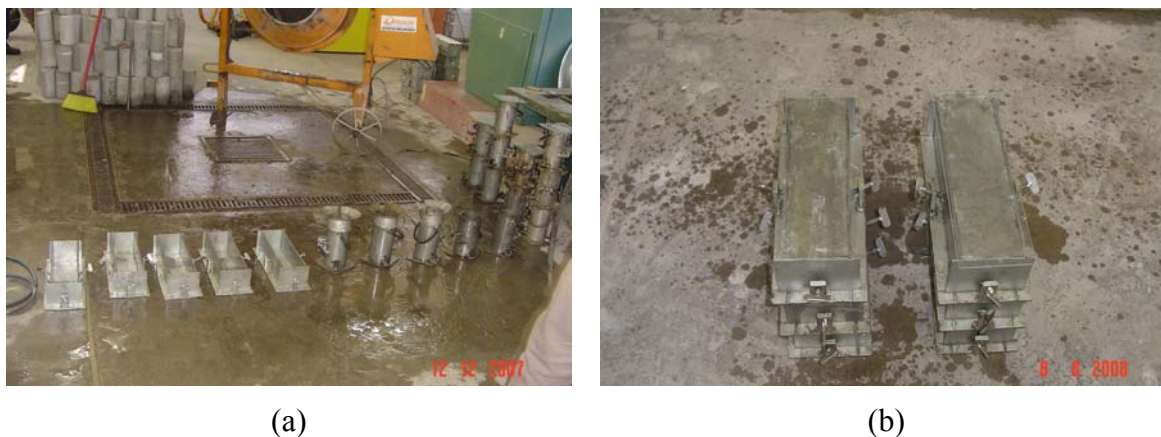
Figura 10: corpos-de-prova em processo inicial de cura (a) CPs cilíndricos; (b) CPs prismáticos
