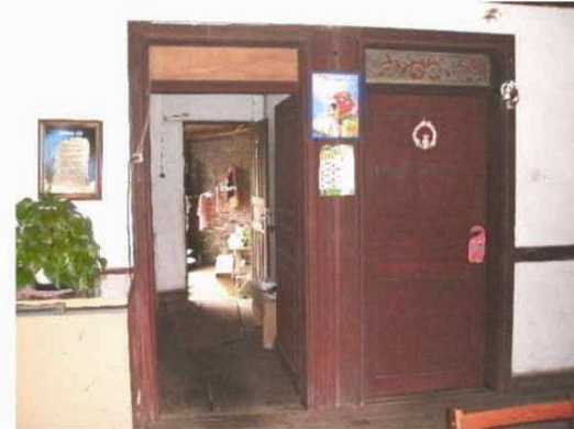
Detalhes das esquarias
