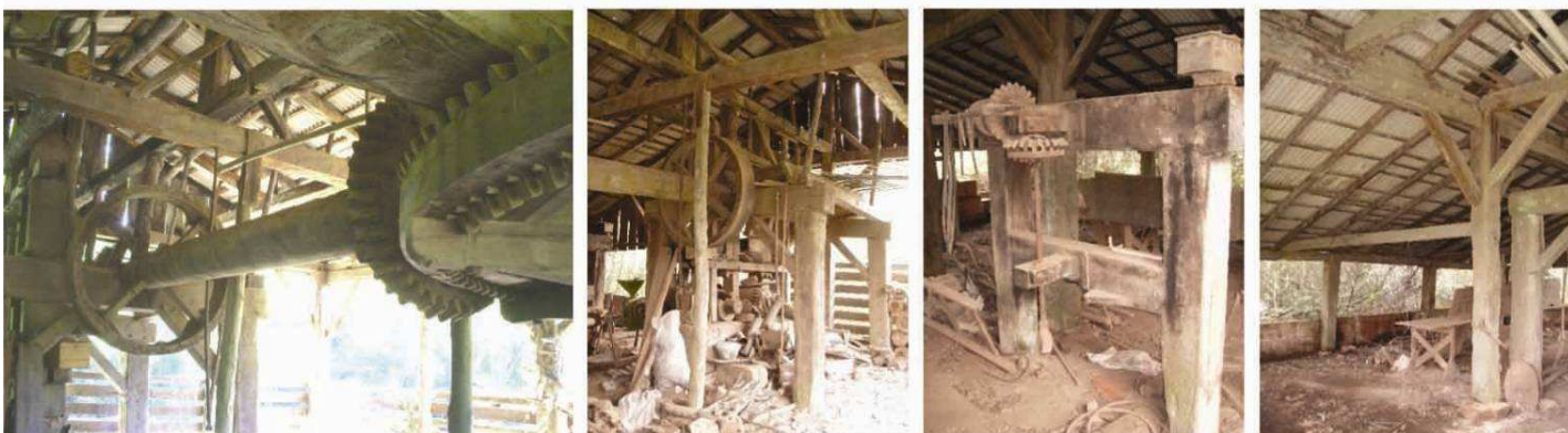
Vistas das engrenagens do moinho em madeira. À direita, vista do anexo do galpão com pé-direito mais baixo.
