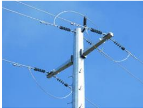
Figura 19 - Linha com isoladores poliméricos.
