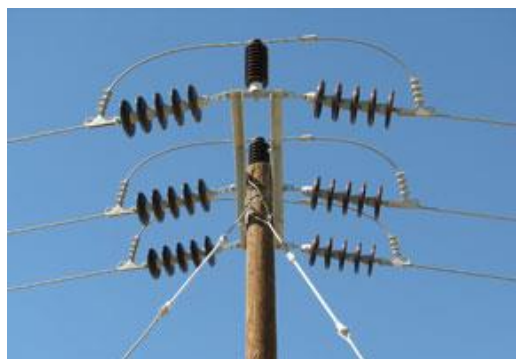
Figura 18 - Linha com isoladores de porcelana.
