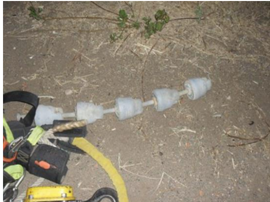
Figura 17 - Vandalismo em isoladores de porcelana.
