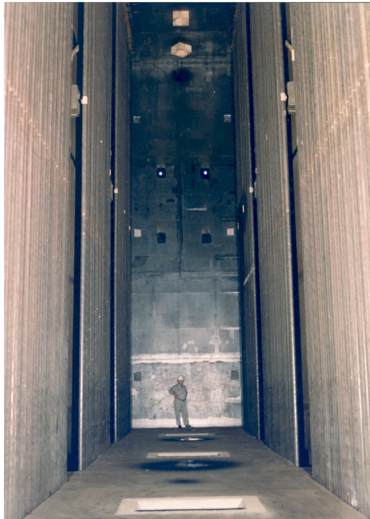
Figura 3.8 - Vista interna do forno de radiação, apresentando nas laterais os tubos de troca térmica ASTM 268 Gr. 446 [PETROBRAS, 1994].
