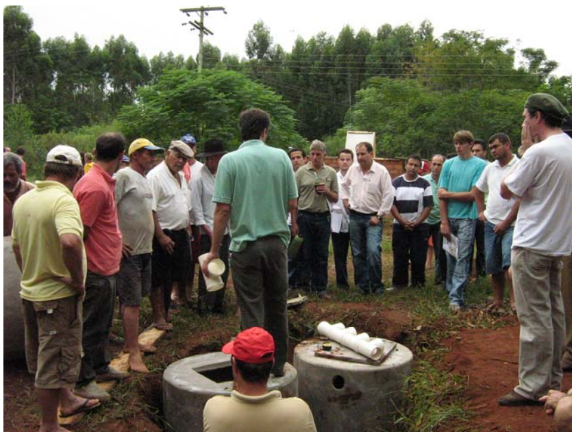
FIGURA 14 – Oficina de instalação e manutenção das fossas sépticas no assentamento Fonte: Pesquisa de campo – 2007.
