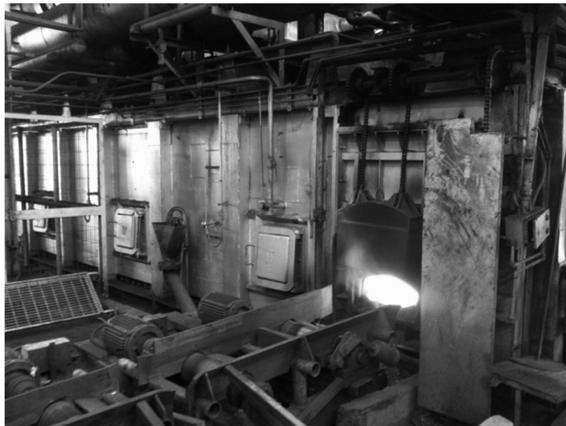
Figura 14 Forno de reaquecimento para laminação de tarugos. Fonte: CORTESIA DE USINA SIDERÚRGICA
