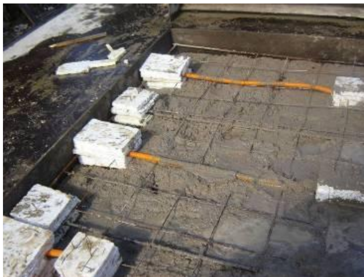
Figura 28: Instalación Eléctrica incorporada
