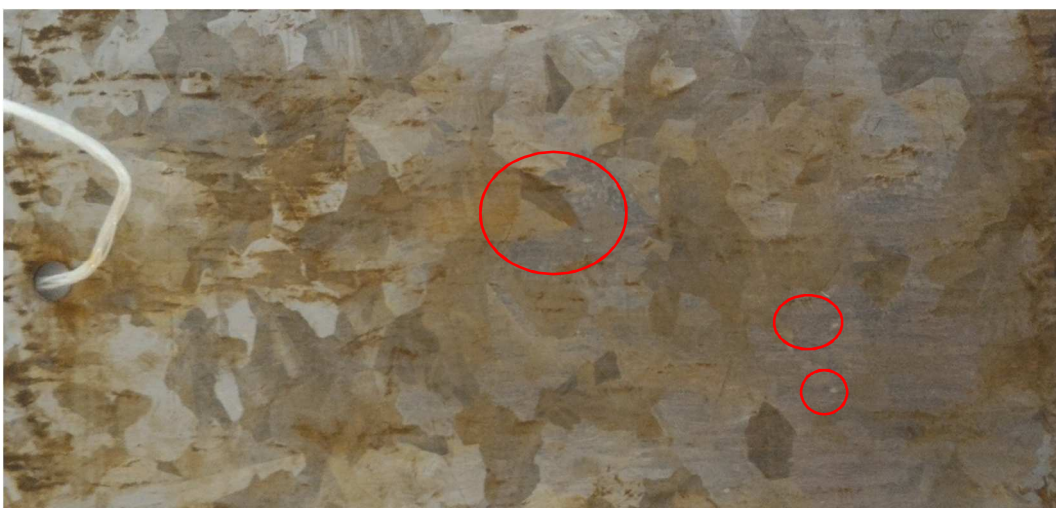
Figura 31 – Peça de aço galvanizado com revestimento de tanino (C_15) após exposição de 2 meses.
