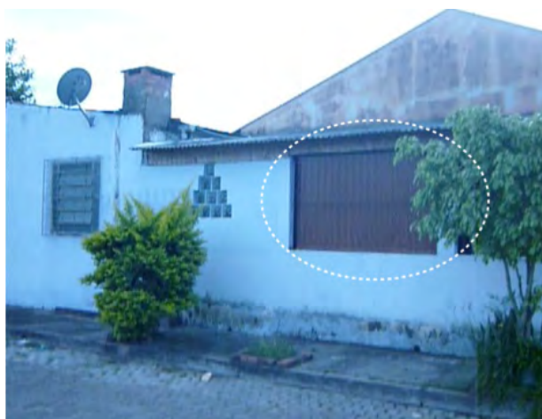
Figura 4.50: Janela vedada com chapa de ferro
