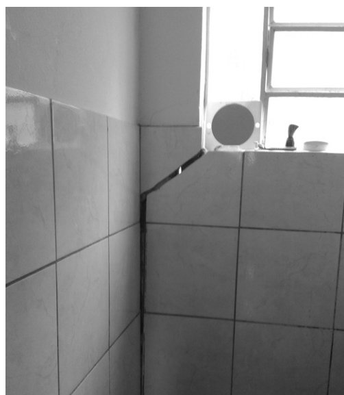
FIGURA 20 | Rachaduras internas (banheiro). Fonte: acervo pessoal (2015).
