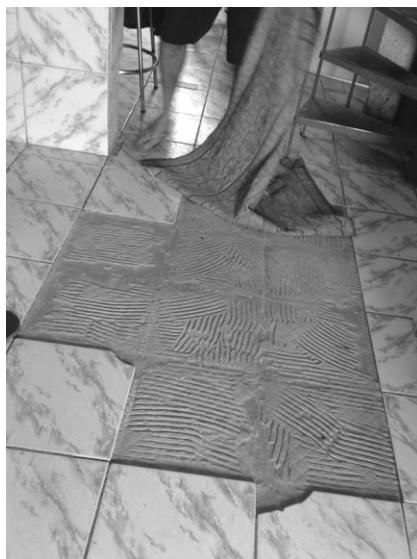
FIGURA 25 | Rachaduras internas (sala). Fonte: acervo pessoal (2015).
