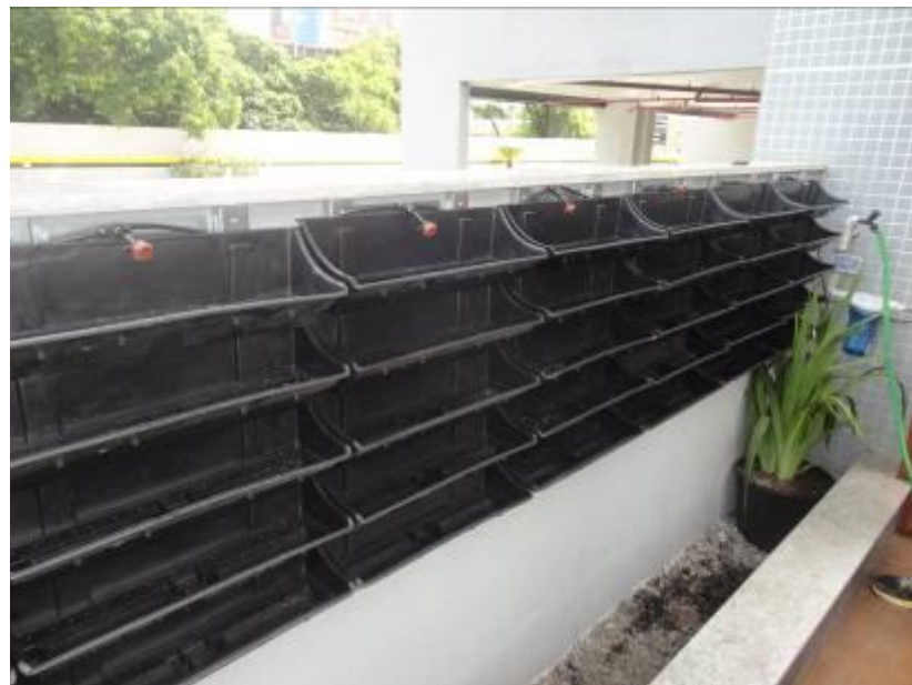
Figura 7 - Sistema Jardim Vertical da Ecotelhado, instalado no dia 23 de janeiro de 2015 em um empreendimento comercial Rossi, localizado na Av. Mostardeiros em Porto Alegre-RS.
