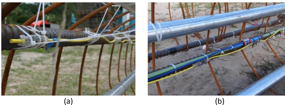
Figura 5. 19 - Detalhe dos cabos a) e em b) dos tubos para execução do ensaio TIP
