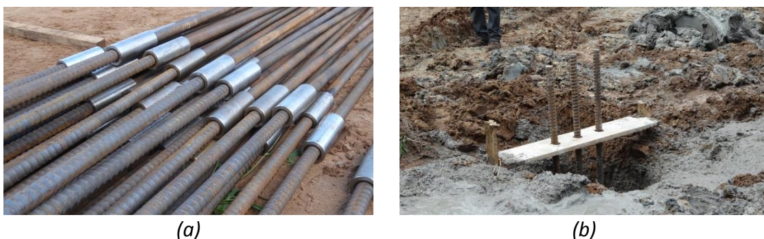
Figura 5. 7 - Detalhe da armadura das estacas de reação a) montagem b) esperas expostas
