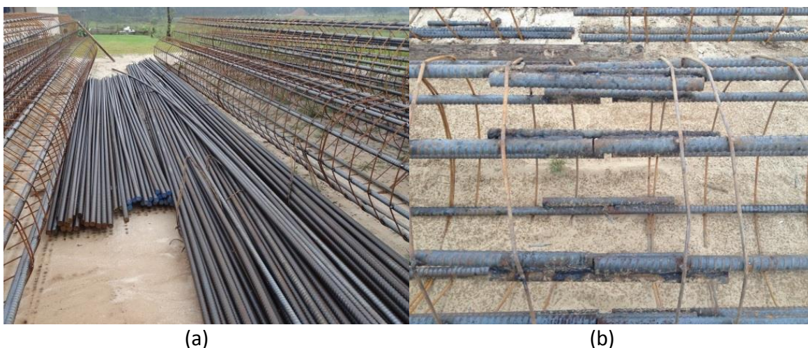
Figura 5. 1 – Detalhes da armadura das estacas ensaiadas em a) armadura segmentada e b) soldada
