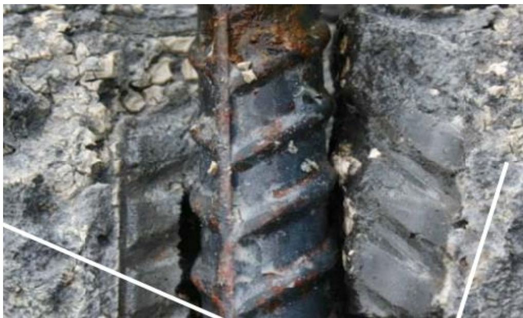
Figura 2. 2 – Resíduos de bentonita junto à armadura da estaca (Mullins e Winters, 2013)
