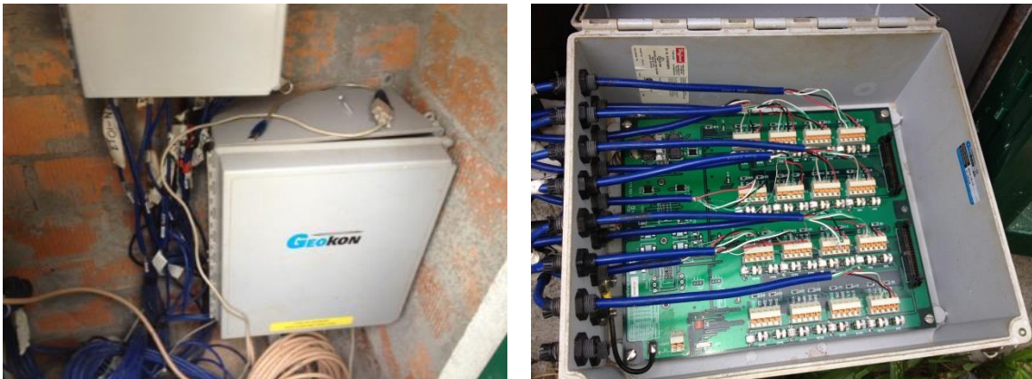
Figura 6. 7 – Detalhe do sistema de aquisição de dados da instrumentação em profundidade
