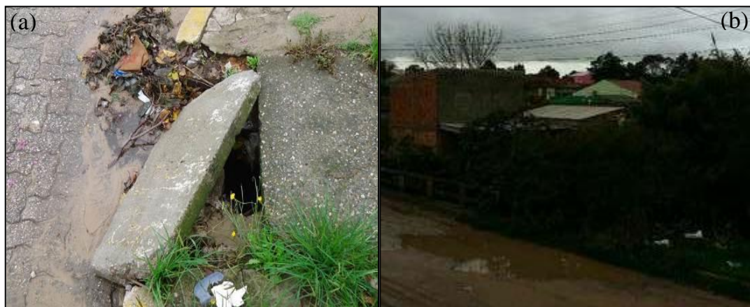
Figura 9. Boca de lobo entupida (a); alagamento na rua (b).
