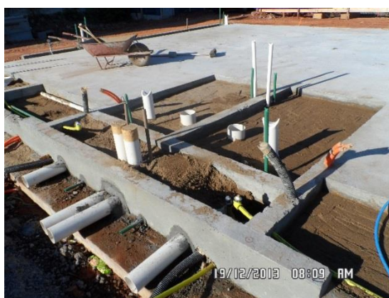
Figura 17 – Vista geral do radier com as instalações hidrossanitárias já posicionadas sob camada de 20 cm de areia
