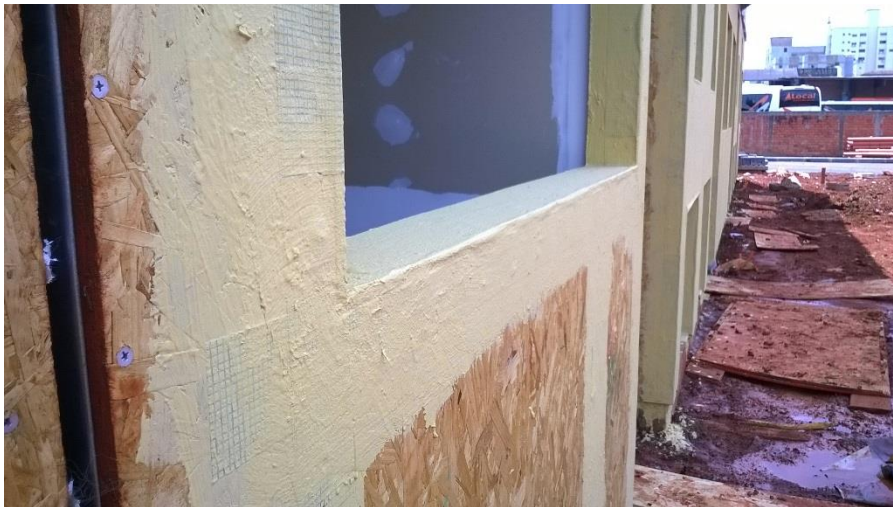
Figura 38 – Detalhes de reforços em janelas
