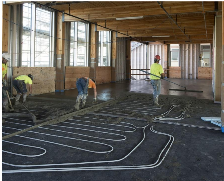
Figura 9 – Tubos de PEX para o sistema de aquecimento e resfriamento
