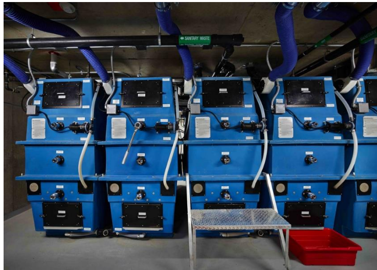
Figura 10 – Sistema de compostagem Phoenix
