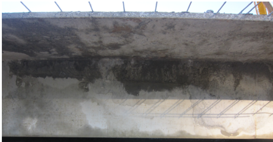
Figura 18 – Manchas presentes em pré-moldados
