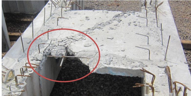
Figura 9 – Exemplo de quebras em pré-moldados
