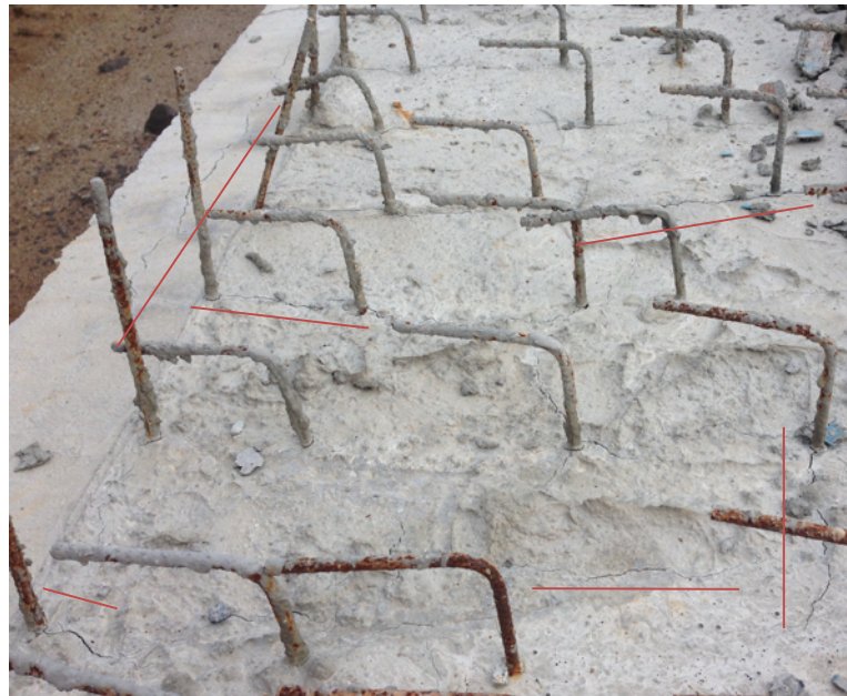
Figura 16 – Fissuras em pré-moldados
