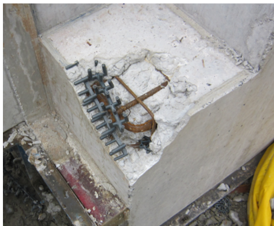
Figura 10 – Exemplo de armadura exposta
