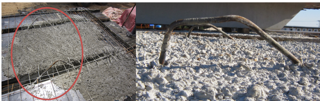
Figura 11 – Escoamento das alças de içamento
