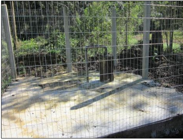
Figura 5.11: Poço com proteção externa
