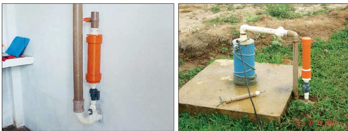
Figura 3.2: Clorador simplificado da FUNASA instalado em reservatório e poço (Fonte: BRASIL, 2014b)
