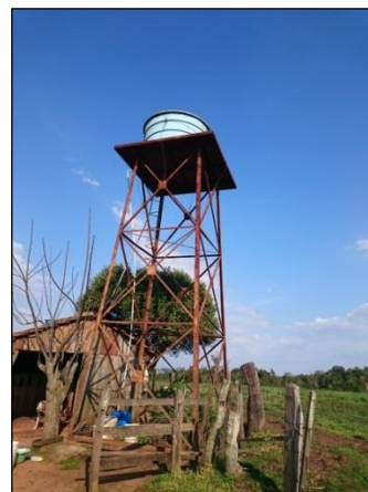
Figura 5.15: Reservatório elevado em condições inadequadas de conservação
