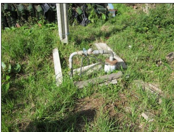
Figura 5.9: Poço sem proteção externa
