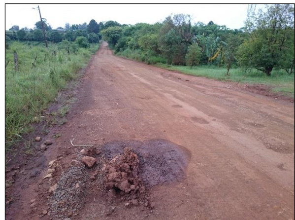
Figura 5.20: Vazamento na rede de distribuição localizada no terço de estrada pouco movimentada
