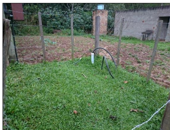
Figura 5.10: Poço sem selo sanitário
