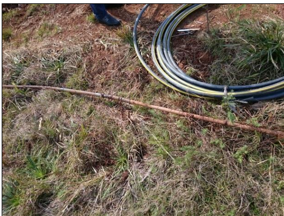
Figura 5.19: Tubulação antiga que apresentava vazamentos e nova a ser substituída em diâmetro inferior ao recomendável
