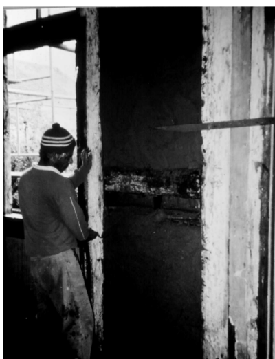
Fotografia 90 - Restauração das vedações de taipa de mão na Casa Schmitt-Presser. Foto: Ana Meira. Arquivo IPHAN/RS.
