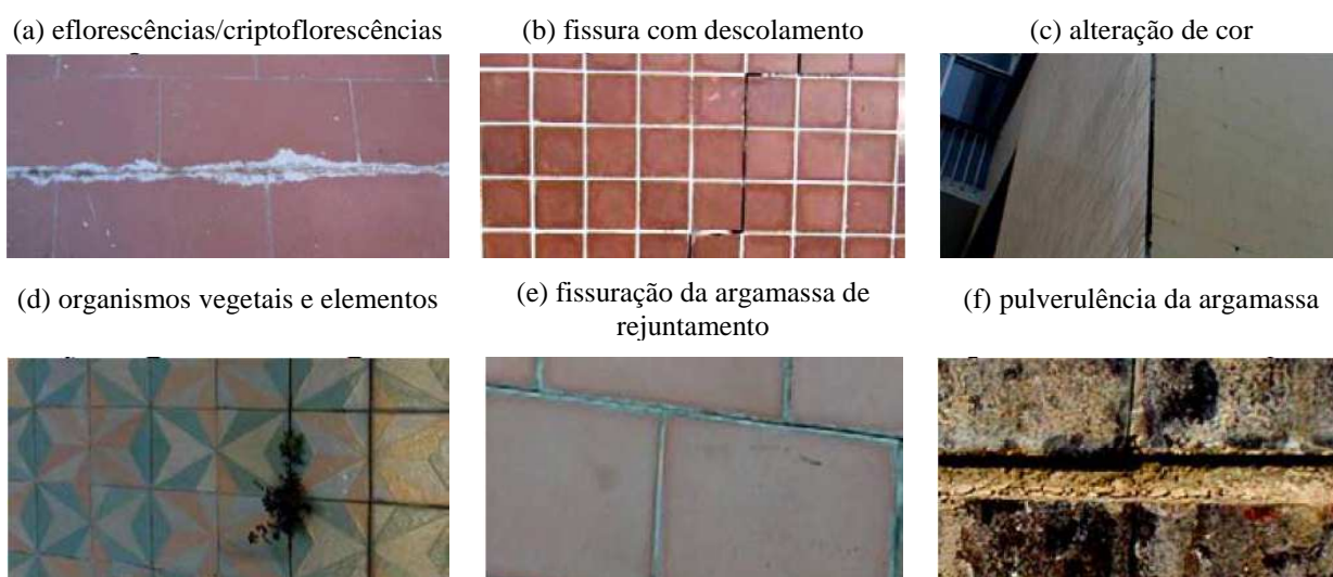
Figura 7 – Manifestações patológicas em juntas de assentamento de revestimentos cerâmicos
