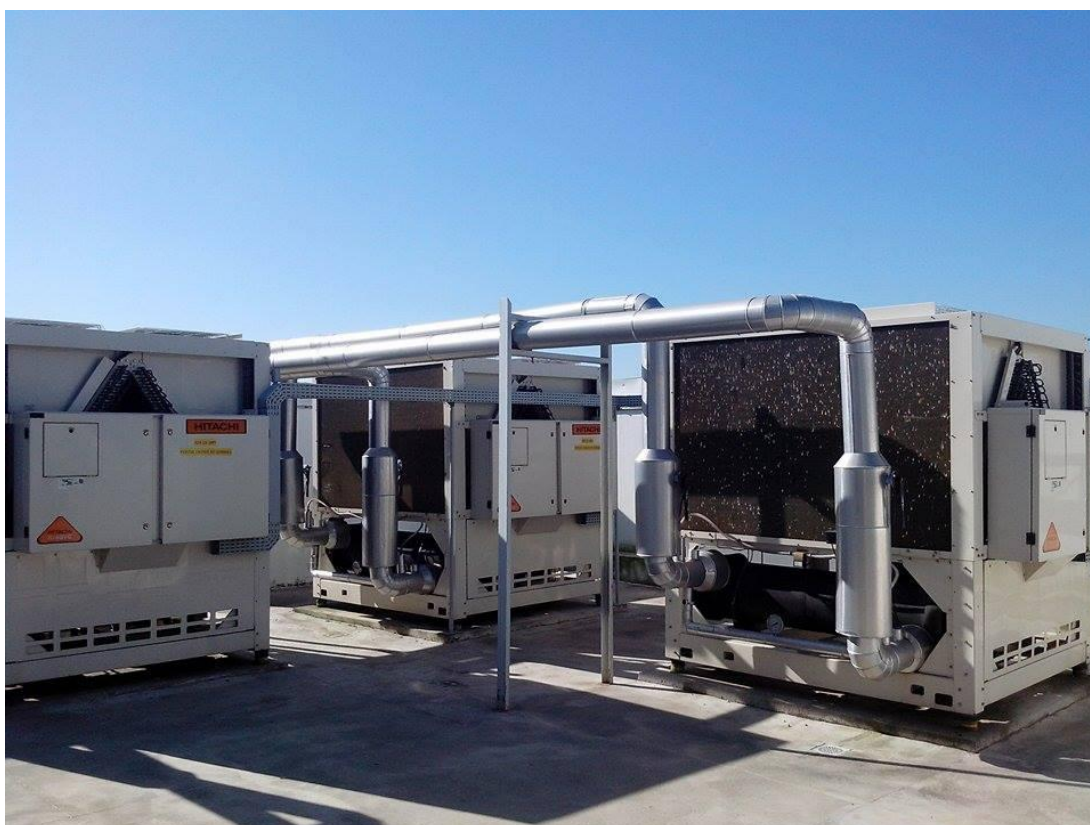
Figura 27 – Foto dos das centrais de água gelada da linha RS8.
