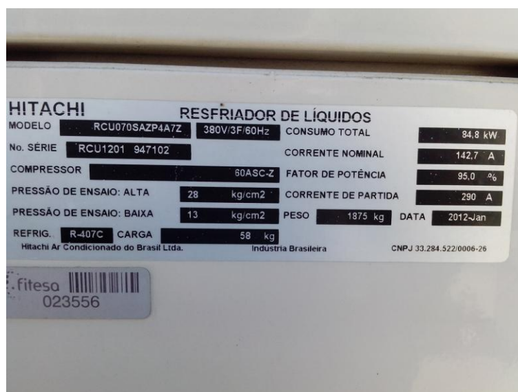
Figura 28 – Placa de identificação e dados do fabricante do equipamento.
