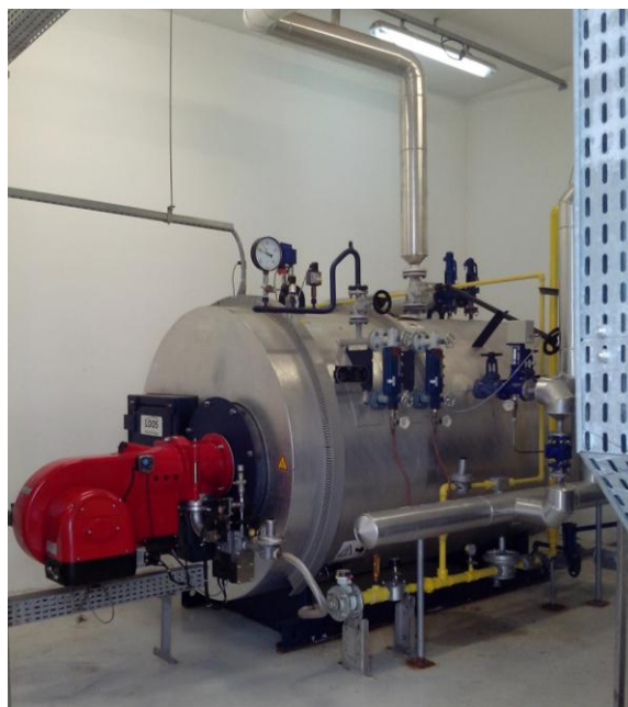
Figura 20 – Caldeira de vapor.
