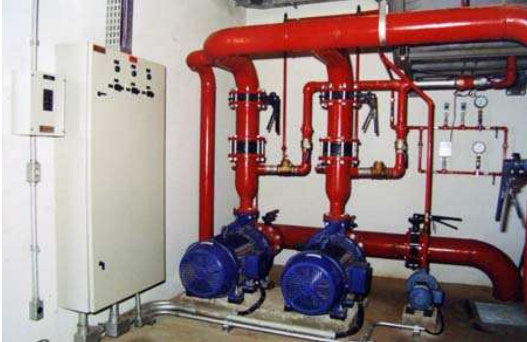
Figura 8– Sistema de bombas
