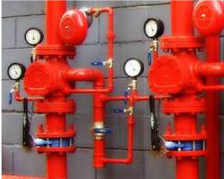
Figura 9– Sistema de controle e alarme
