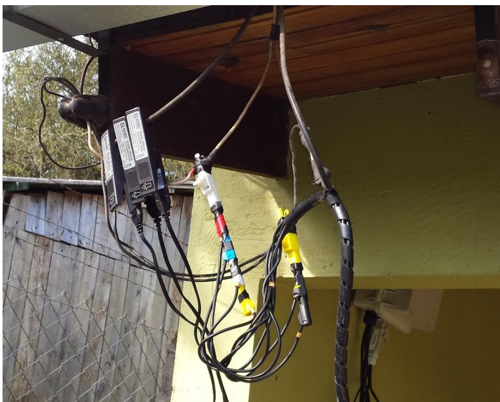
Figura 13 - Instalação do analisador no ponto de aquisição dos dados.
