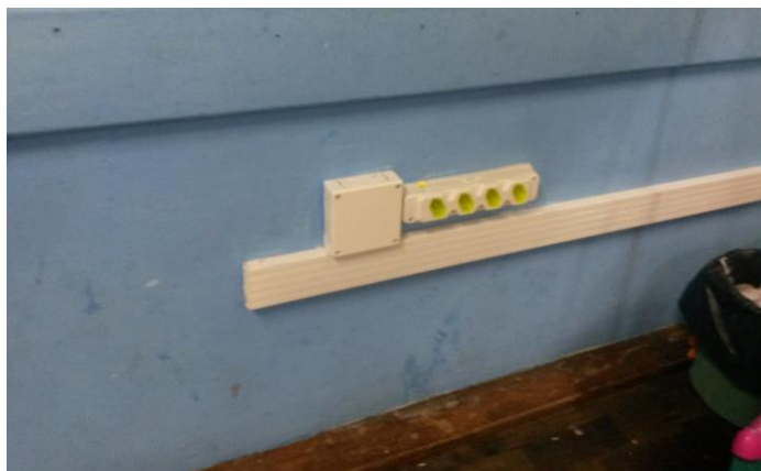
Figura 5.1 – Rede Elétrica na Sala de aula.
