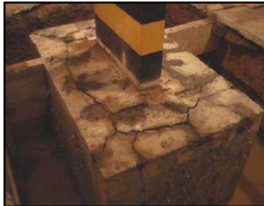
Figura 1 - Estrutura degradada pela RAS em Recife, Brasil. Fonte: ANDRADE (2006).
