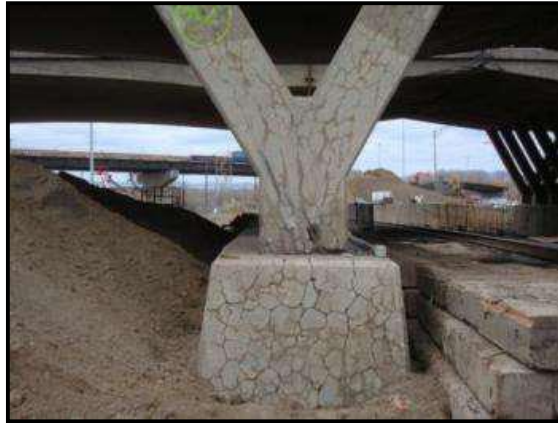
Figura 2 - Estrutura degradada pela RAS no Viaduto Robert-Bourassa - Charest, Québec, Canadá. Fonte: SANCHES (2010).
