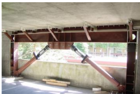
Figura 3.2 – Amortecedores viscosos instalados numa estrutura.
