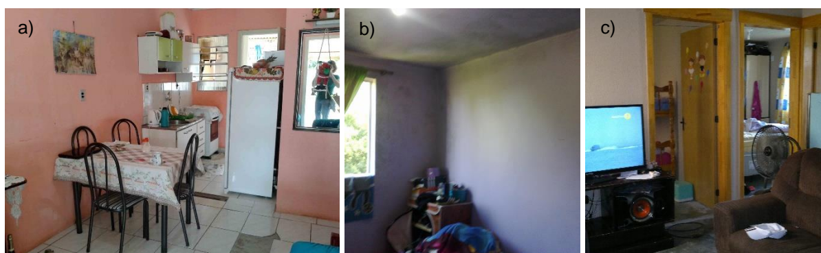
Figura 49: exemplos observados dos problemas apontados: (a) revestimento do piso descolou e quebrou e manchas de umidade na parede esquerda; (b) dormitório com mofo nas paredes e teto; e (c) áreas secas sem revestimento de piso
