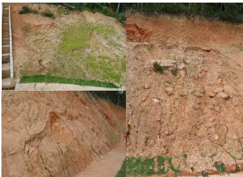
Figura 152: Rupturas rasas junto à superfície de ruptura crítica.
