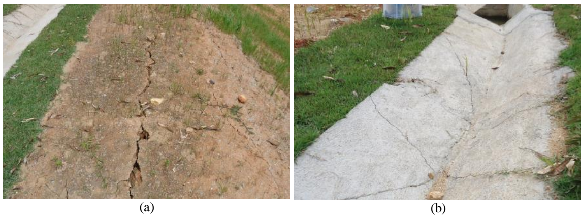
Figura 30: Evidências de movimentos junto às obras executadas em julho de 2013.
