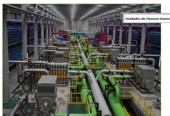
Figura 3.8: Unidades de Osmose Inversa na planta de dessalinização de Barcelona, Espanha. Adaptado de Mañueco (2015).
