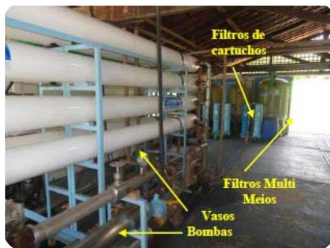
Figura 3.3: Equipamentos para o pré-tratamento e processo de dessalinização por osmose inversa em Fernando de Noronha. Adaptado de Tavares (2015).
