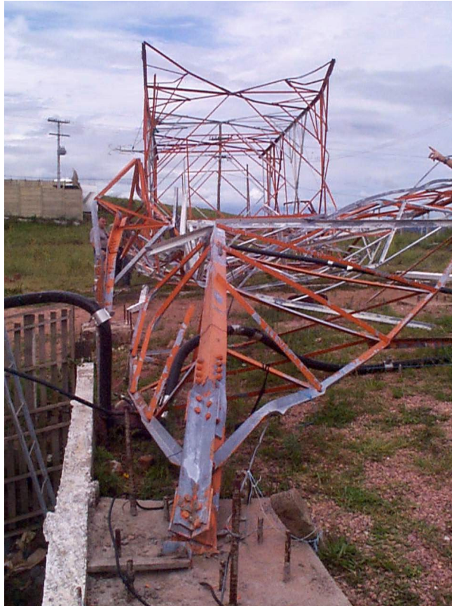
Figura 1: Torre metálica treliçada acidentada (Porto Alegre, 2000).
