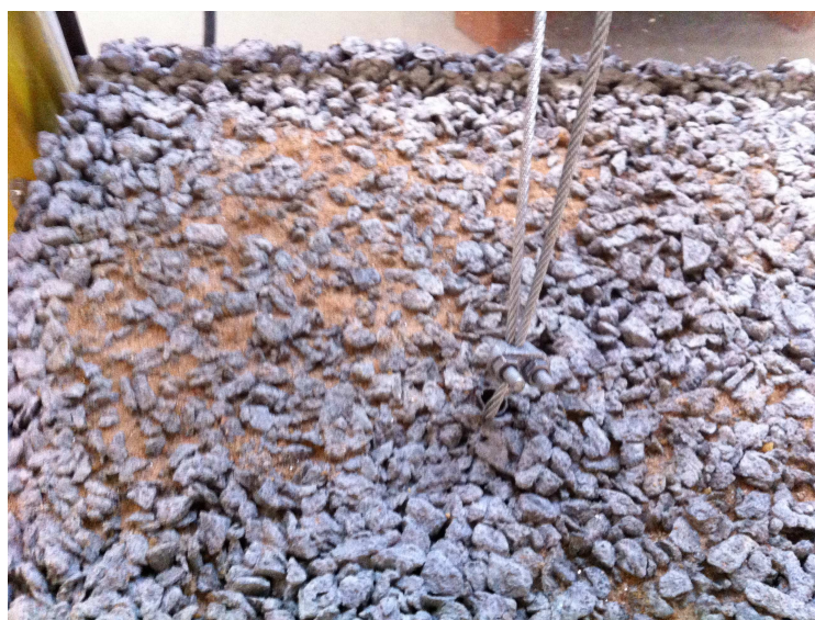
Figura 73: colmatação superficial na placa de concreto permeável
