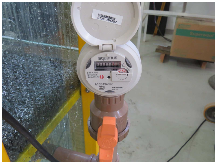
Figura 66: hidrômetro utilizado para medição da vazão de água do Dispositivo 1
