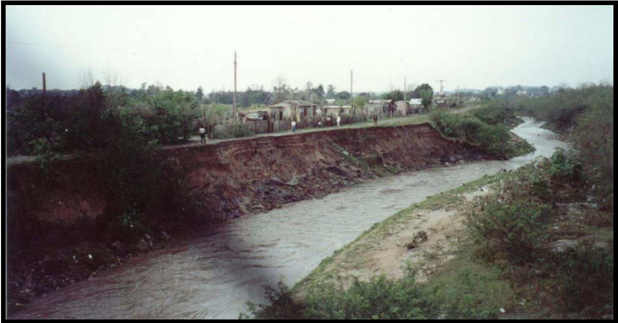
Figura 18: Área de Risco a dinâmica fluvial - Erosão de margem na Vila Oliveira. Oliveira (4/2003)
